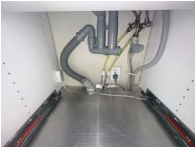
Røropplegg i kjøkkenbenk med Waterguard
