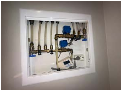
Samleskap med rørkurser og stoppekraner
