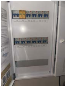
Sikringsskap med automatsikringer.
