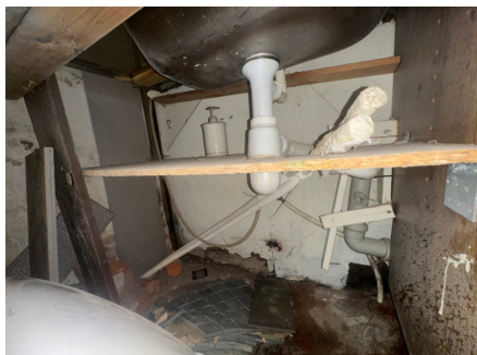
Rørlegg på kjøkken
