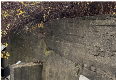
Sprekkdannelse i støttemur
