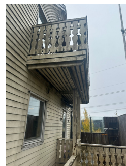
Avskalling og fuktmerker på balkong
