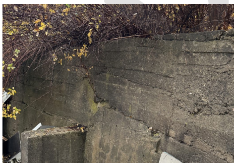
Sprekkdannelse i støttemur
