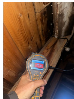
Det er påvist fuktskjolder/skader i takkonstruksjonen.
