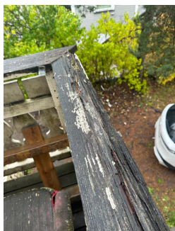
Råteskader i rekkverk på balkong
