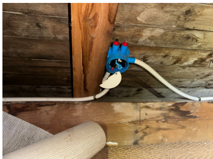
Ødelagt dekklokk på koblingsboks på loft
