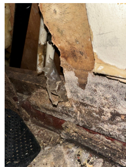
Mugg i vegg på kjøkken i benkeskap
