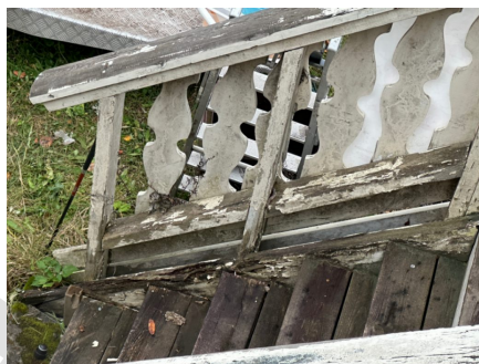
Fukt og råte itrapp mot terreng
