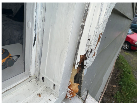
Råte i vindu mot stue
