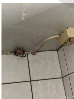
Manglende koblingsboks på kjøkken
