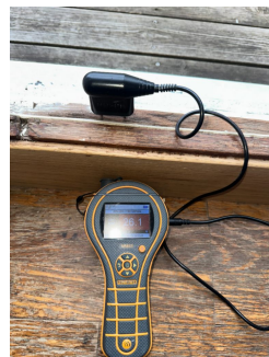
Fukt utslag i terskel på terrassedør
