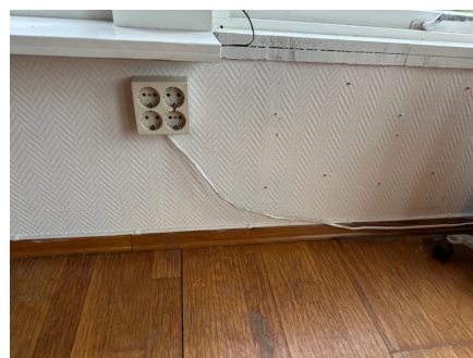
Løse ledninger fra stikkontakt på stue
