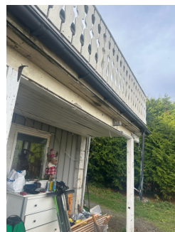
Avskalling i underkant av terrasse
