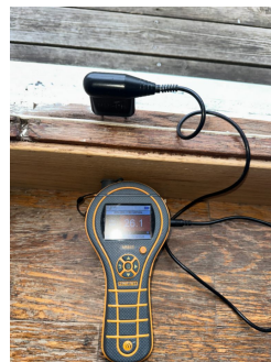
Fukt utslag i terskel på terrassedør
