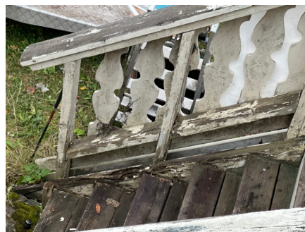
Fukt og råte itrapp mot terreng
