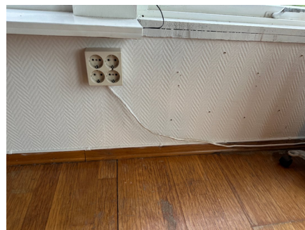
Løse ledninger fra stikkontakt på stue
