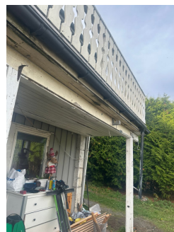
Avskalling i underkant av terrasse
