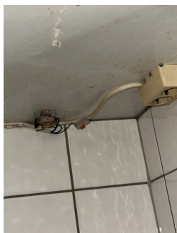
Manglende koblingsboks på kjøkken
