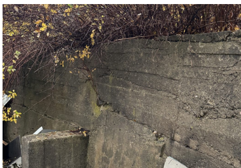
Sprekkdannelse i støttemur
