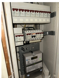
Sikringsskap med automatsikringer.
