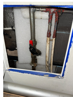
Stoppekran plassert i bolig 32 C
