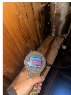
Det er påvist fuktskjolder/skader i takkonstruksjonen.
