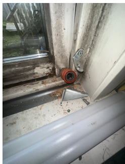
Vundu med råteskade og hull for vannslange
