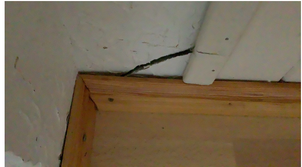
Sprekk i pipe.
