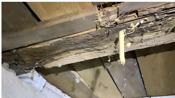
Eksempel på råteskadet gulvbjelke.
