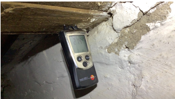
Det måles skadelig fuktinnhold i gulvbjelke.
