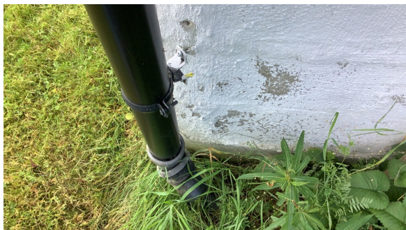
Klammer for nedløpsrør har løsnet.
