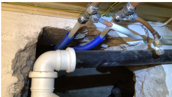
Eventuelt lekkasjevann ledes til kjeller uten sluk.
