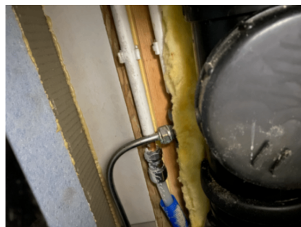
Det er ikke montert tettemuffer i enden av varerør i rørsjakt på badet.
