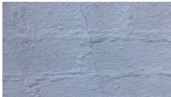
Skråriss i murvegg.
