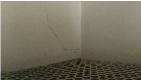
Riss i pipe.
