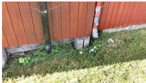
Mangelfull bortledning av takvann.
