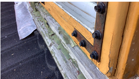
Eksempel på værslitt vindu.
