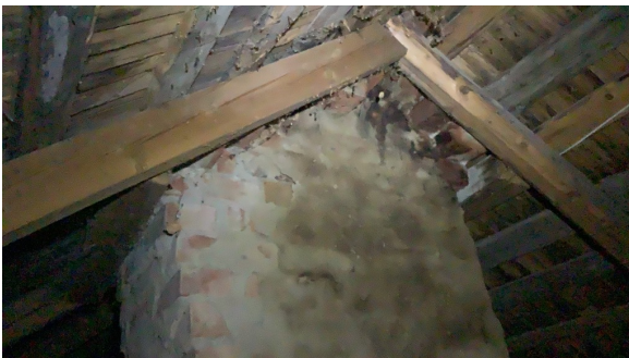
Fuktskjolder rundt pipe.
