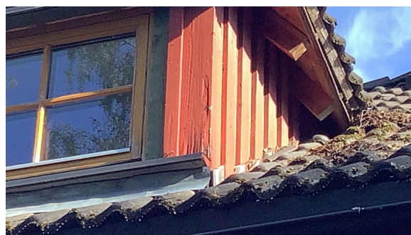
Råteskadet bordkledning på takoppløft.
