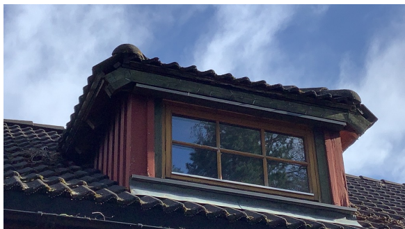
Nederste steinlekt er fuktskadet på takoppløft.
