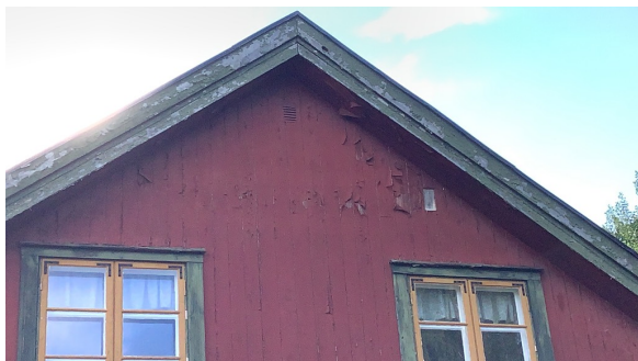
Eksempel på værslitt kledning.
