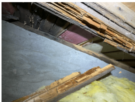
Eksempel på råteskadet gulvbjelke.
