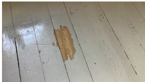
Slitasje i gulv.
