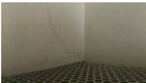
Riss i pipe.
