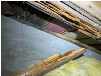
Eksempel på råteskadet gulvbjelke.
