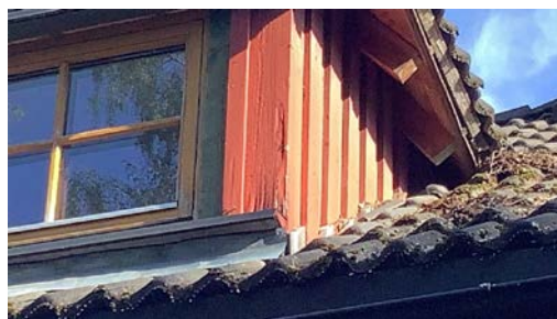
Råteskadet bordkledning på takoppløft.
