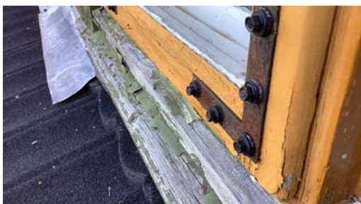
Eksempel på værslitt vindu.
