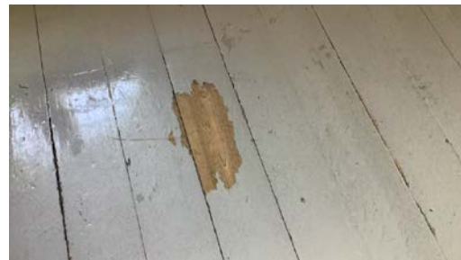
Slitasje i gulv.
