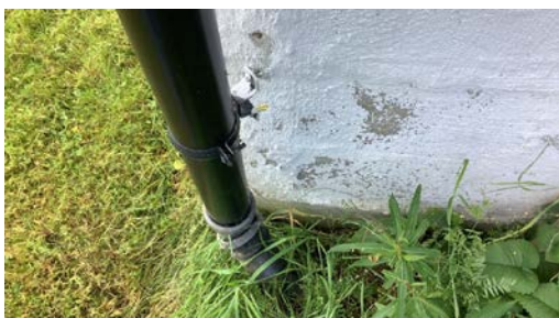
Klammer for nedløpsrør har løsnet.
