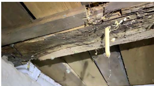
Eksempel på råteskadet gulvbjelke.
