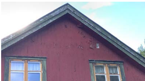
Eksempel på værslitt kledning.
