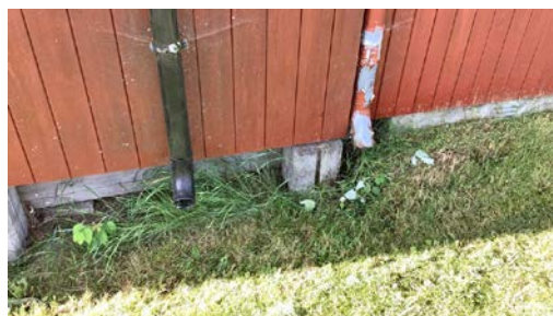
Mangelfull bortledning av takvann.
