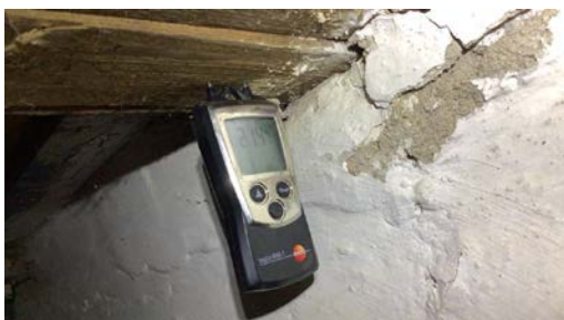
Det måles skadelig fuktinnhold i gulvbjelke.
