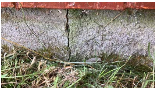
Eksempel på utvendig skråriss.
