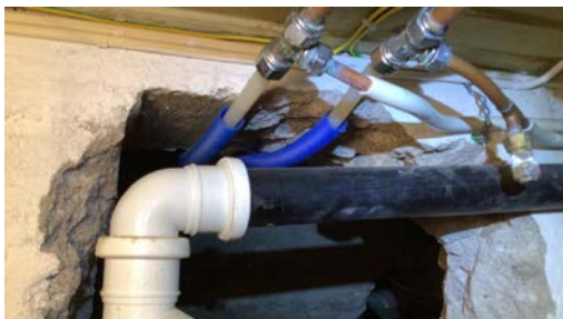
Eventuelt lekkasjevann ledes til kjeller uten sluk.
