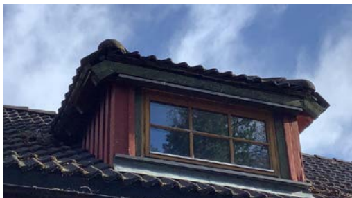
Nederste steinlekt er fuktskadet på takoppløft.
