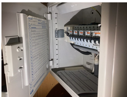
Sikringsskap i skap på soverom.
