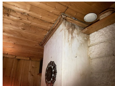
Lekkasje rundt pipe på stue.
