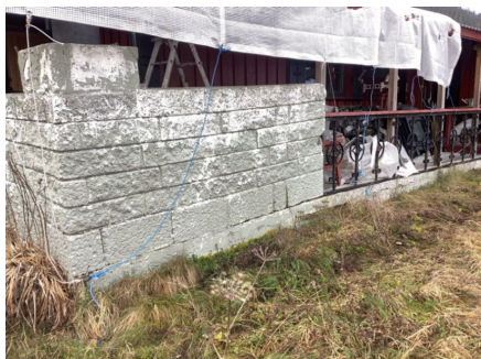
Skjevheter i konstruksjonen.
