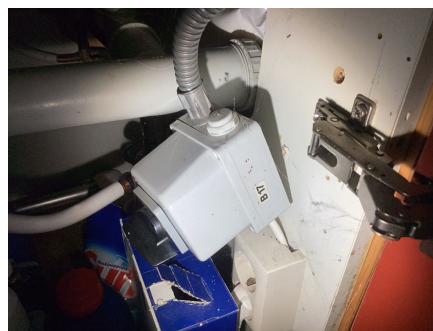
Løs el-boks til varmtvannstank i kjøkkenskap.
