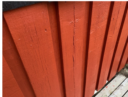
Kledning bærer preg av slitasje.
