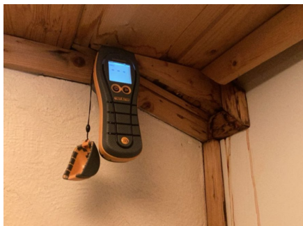
Lekkasje rundt pipe på bad.
