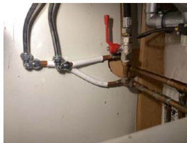
Stoppekran i kjøkkenbenk.
