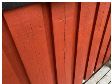
Kledning bærer preg av slitasje.
