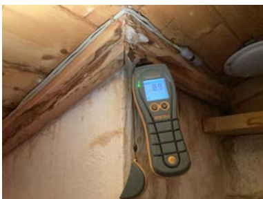
Lekkasje rundt pipe på stue.
