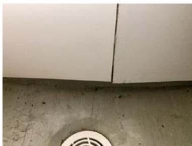
Løse baderomsplater med fuktskade.
