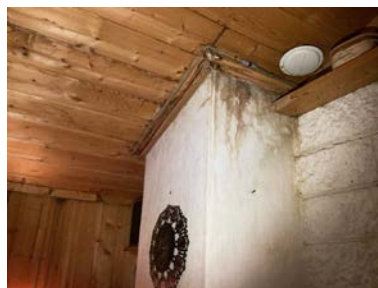
Lekkasje rundt pipe på stue.
