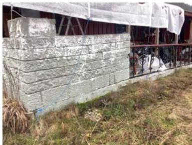
Skjevheter i konstruksjonen.
