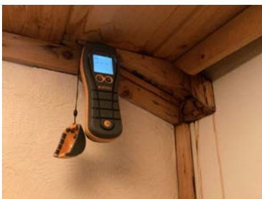
Lekkasje rundt pipe på bad.
