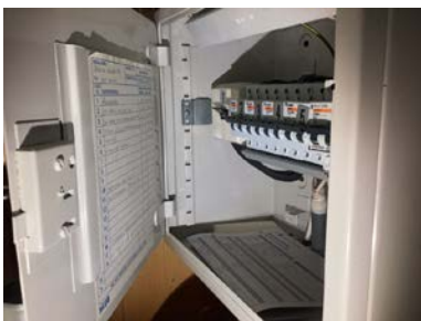
Sikringsskap i skap på soverom.
