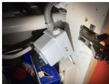
Løs el-boks til varmtvannstank i kjøkkenskap.
