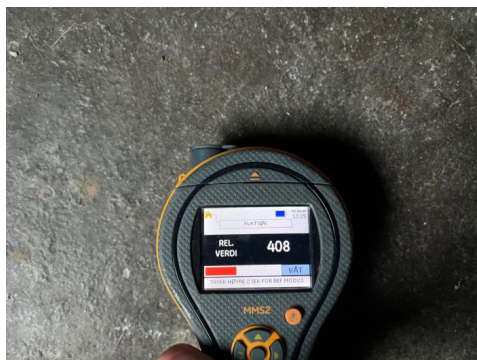
Fuktindikasjon i lagerrom
