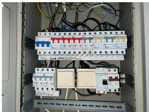
Sikringskapp i ekspedisjonsrom
