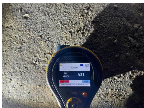
Fuktindikasjon i lagerrom
