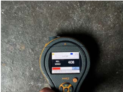
Fuktindikasjon i lagerrom
