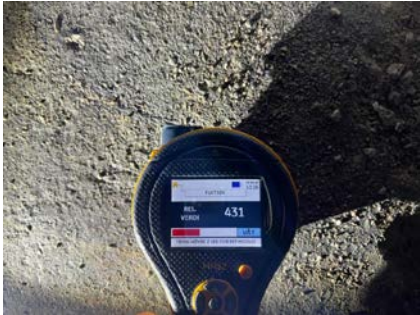
Fuktindikasjon i lagerrom
