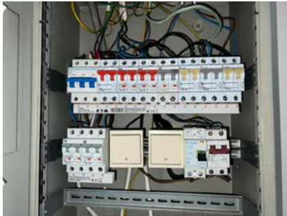
Sikringssskap i ekspedisjonsrom
