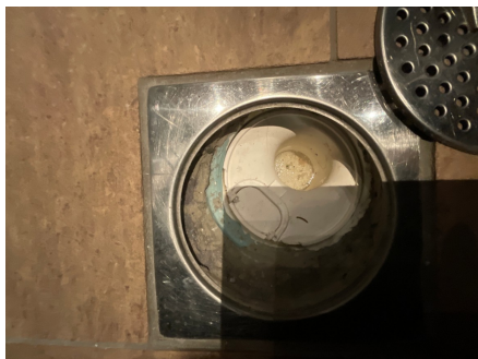
Sluk ved servantskap
