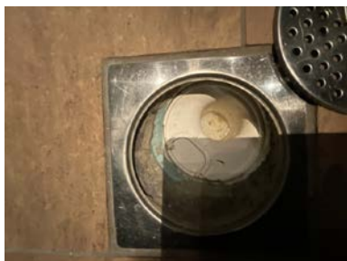
Sluk ved servantskap
