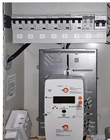
Elektrisk anlegg - [Sikringskap leilighet]
