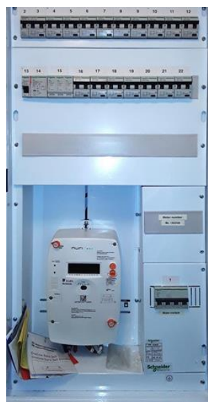
Elektrisk anlegg - [Sikringsskap hoveddel]
