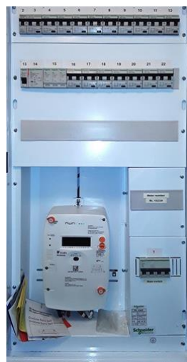
Elektrisk anlegg - [Sikringsskap hoveddel]
