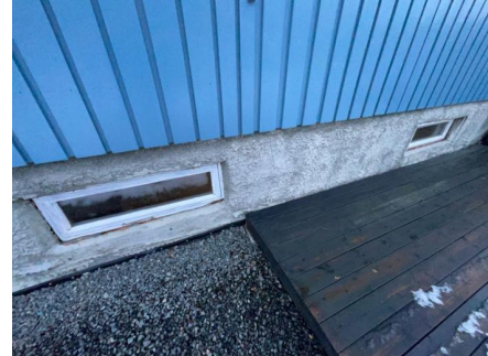
Vinduer i vaskekjeller og uinnredet kjellerrom er ikke pusset inn i mur eller mangler beslag/omramning i mur.
