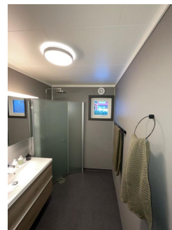
Vindu er plassert i våtsone like ved dusjvegger
