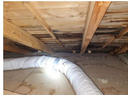
Fuktskader er synlig i undertak mot nord
