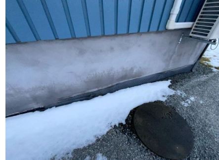
Synlig grunnmursplast på nedre ytre hjørne ved kjellerstue
