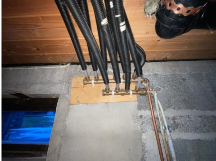
Vannfordelingskolber på vegg
