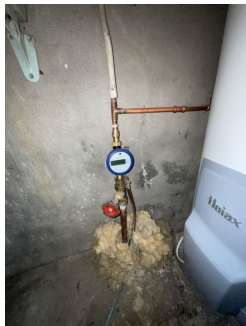
Hovedstoppekrane og vannmåler
