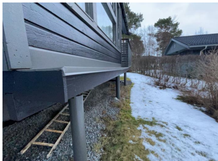
Konstruksjonene har synlig skjevheter
