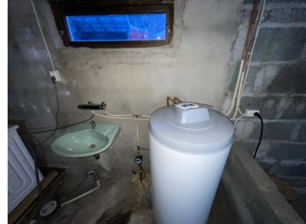
Åpne kobberør på vegg i vaskekjeller
