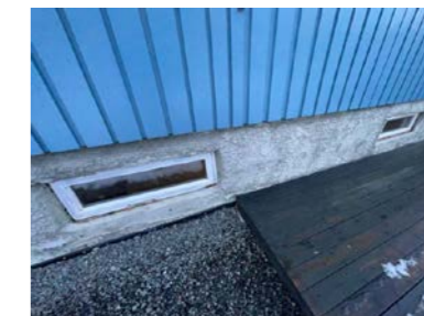
Vinduer i vaskekjeller og uinnredet kjellerrom er ikke pusset inn i mur eller mangler beslag/omramning i mur.
