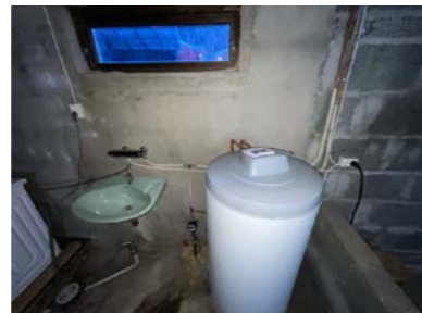
Åpne kobberør på vegg i vaskekjeller
