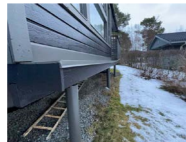
Konstruksjonene har synlig skjevheter
