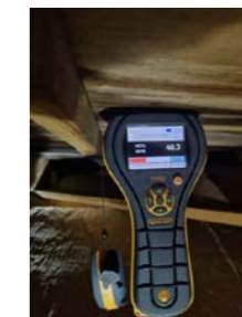
Fuktmåling i undertak viser 40,3%
