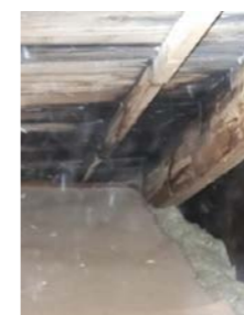
Fuktskader er synlig i undertak mot gavelvegg nord/øst
