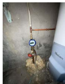
Hovedstoppekrane og vannmåler
