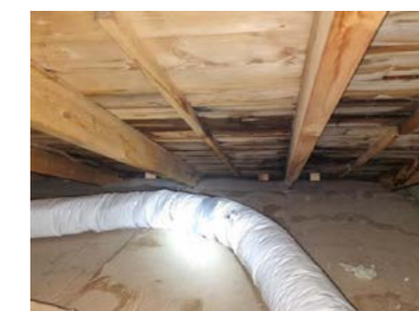
Fuktskader er synlig i undertak mot nord
