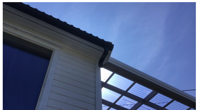
Mangler nedløp langs vegg
