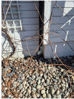
Ingen bortledning av takvann fra grunnmur.
