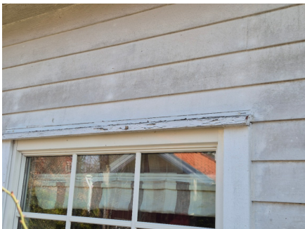
Værslitt vannbrett uten beslag.
