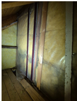
Dampsperre på vegg, noe som er en feil utførelse.
