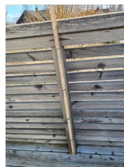
Lavere rekkverk enn dagens krav.
