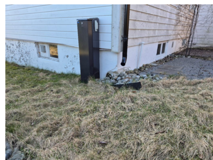
Svakt hellende terreng mot grunnmur.
