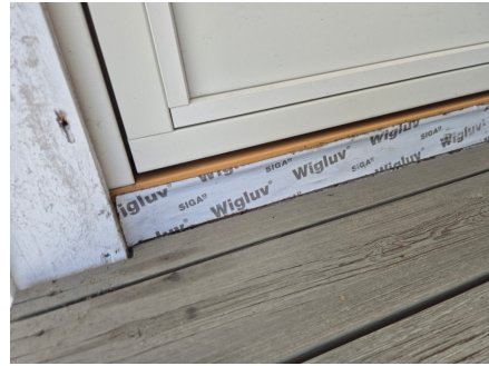
Terrassedør har ingen beslag i nedre del.
