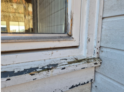
Råteskader i vannbrett.
