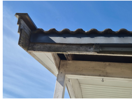
Mangler takrenne i enden til overbygget terrasse.
