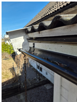
Mangler takfotbeslag over kjellernedgang.
