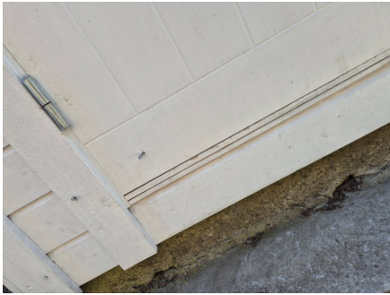
Kjellerdør har ingen beslag i nedre del.
