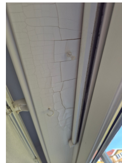
Krakelering av flere vindusforinger.
