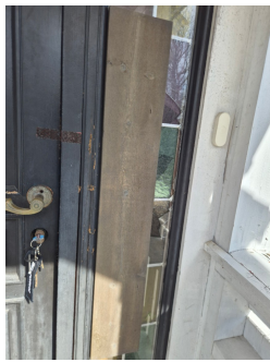
Slitt ytterdør med knust sideglass.
