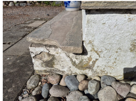
Løst puss og knekt skifer.
