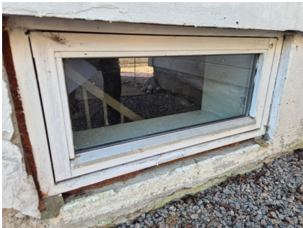
Ikke pusset inn vindu.
