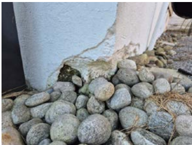
Avskalling av pusslag mot nord-vest.
