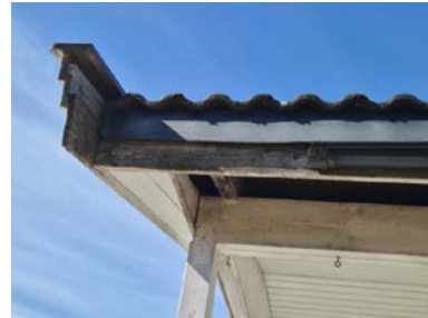
Mangler takrenne i enden til overbygget terrasse.
