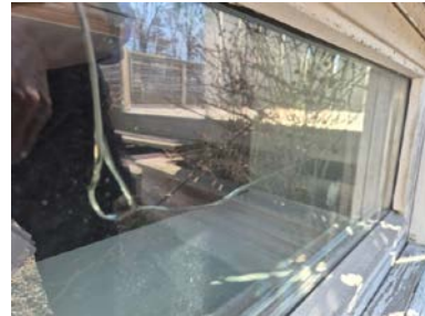
Sprekk i glas, og ingen beslag i bunn.
