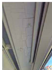
Krakelering av flere vindusforinger.
