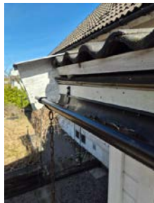
Mangler takfotbeslag over kjellernedgang.
