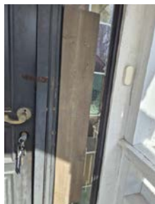
Slitt ytterdør med knust sideglass.
