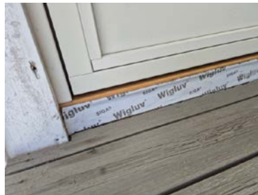
Terrassedør har ingen beslag i nedre del.
