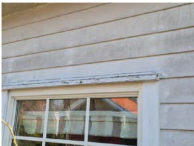
Værslitt vannbrett uten beslag.
