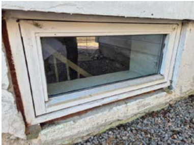
Ikke pusset inn vindu.
