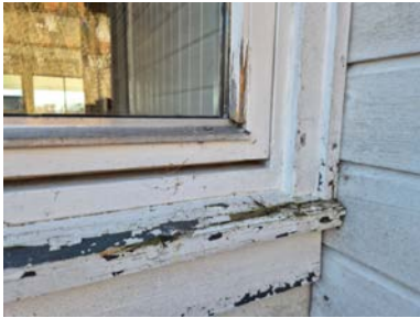
Råteskader i vannbrett.
