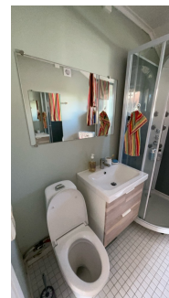
Vask med baderomsinnredning.
