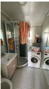
Dusjkabinett og opplegg for vaskemaskin.
