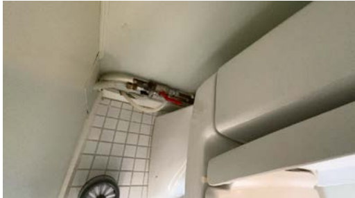
Utsnitt vannrør og stoppekran.
