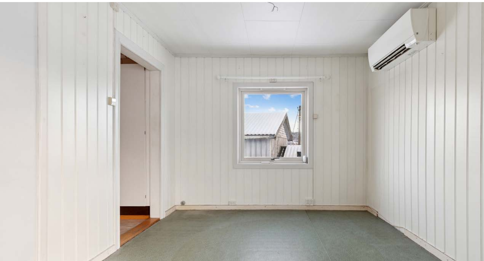
I spisestuedelen er det monteret varmepumpe.
