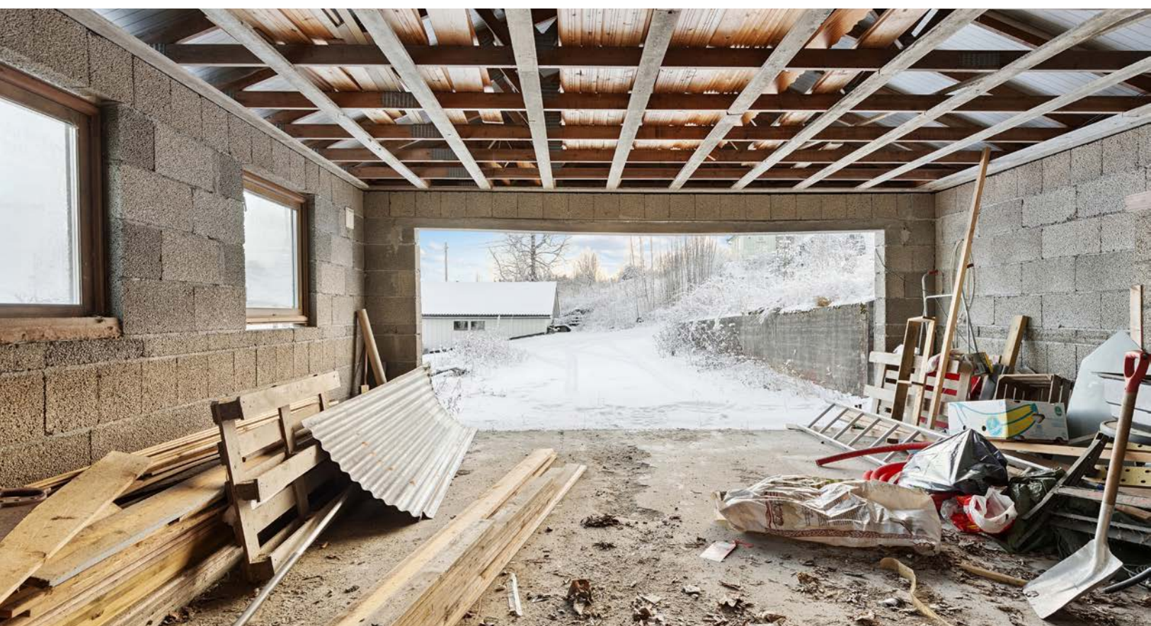
Dobbelgarasje som fremstår noe uferdig.
