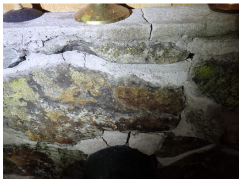
Sprekker i brannmur.
