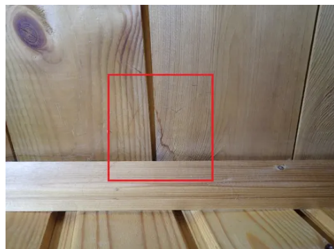
Fuktmerke i panelbord inn mot taklist i det markerte området.
