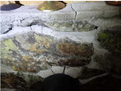
Sprekker i brannmur.
