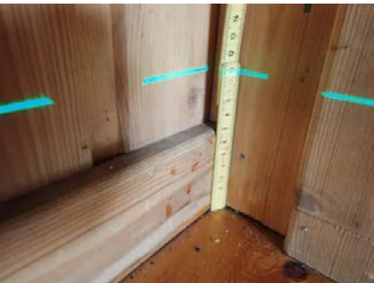
Referansenivå laser = 4 cm. Viser opp mot 7 cm høydeavvik i kjøkken.
