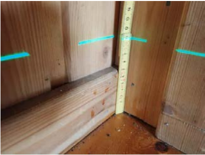
Referansenivå laser = 4 cm. Viser større skjevheter på gulv, og indikerer bevegelser i grunnen.
