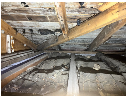
Bilde fra 2025 Noe råteskade på sperre
