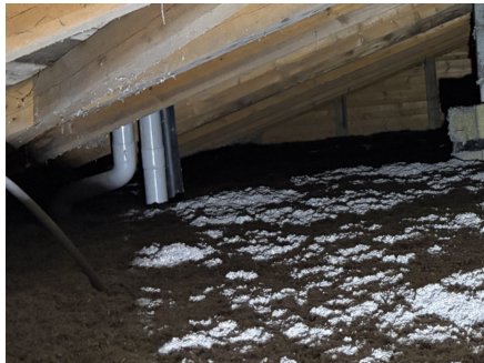
Rør for kloakklufting er uisolert
