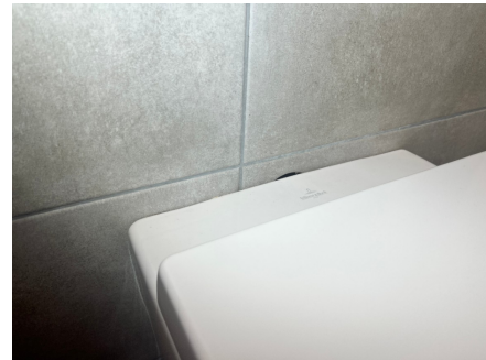
Synlig åpning i flis over toalett
