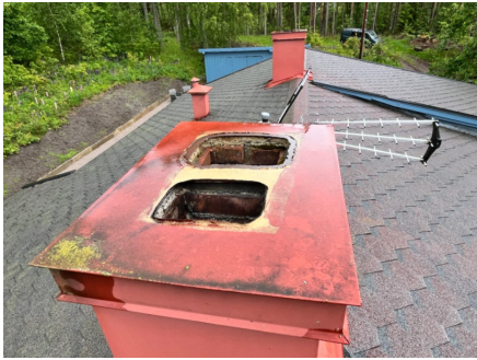
Noe rust og ingen topp avdekning.
