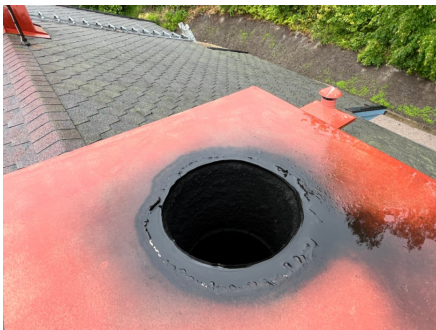
Ikke montert topp avdekning
