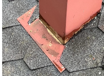
Synlige spiker på takhatt
