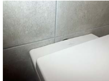
Synlig åpning i flis over toalett
