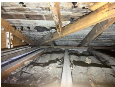
Bilde fra 2025 Noe råteskade på sperre
