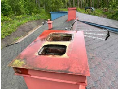
Noe rust og ingen topp avdekning.
