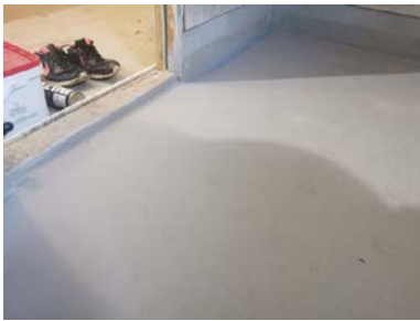
Vanntett oppbrett på membran under dør
