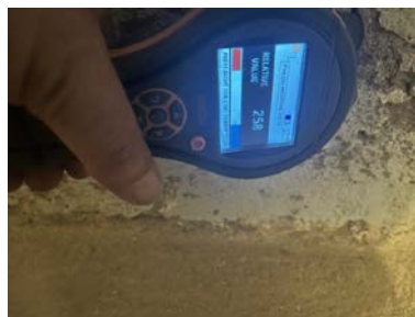
Fuktkontroll på innside av grunnmur mot øst, saltutslag på vegg.
