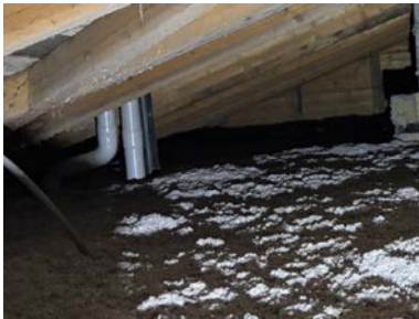
Rør for kloakklufting er uisolert
