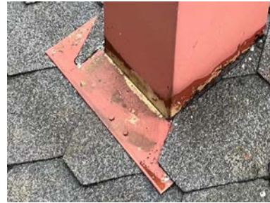
Synlige spiker på takhatt
