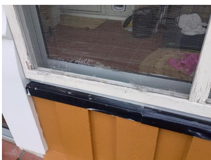
Skade på myggetetting.
