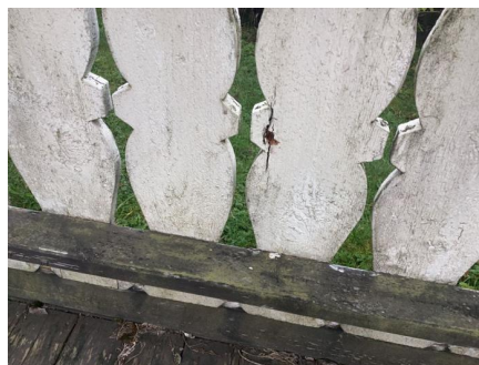
Eksempel på råte i kledningsbord.
