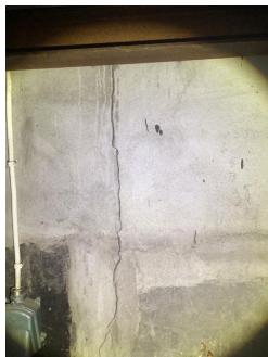
Eksempel på sprekk i grunnmur.
