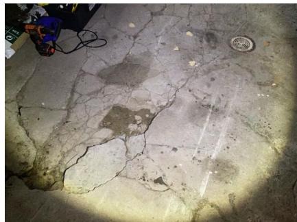
Oppsprekking i gulv i garasje.
