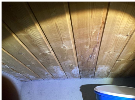
Fuktmerker i himling på ett bodrom.
