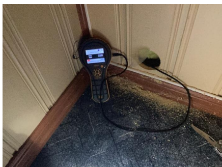
Fuktmåling i utforet veggkonstruksjon på over 20 vektprosent.
