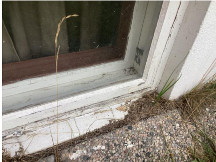
Eksempel på slitasje på vindu.
