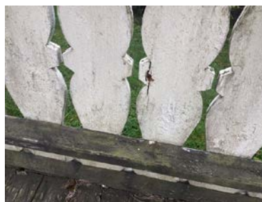
Eksempel på råte i kledningsbord.
