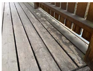
Eksempel på slitasje på gulv.
