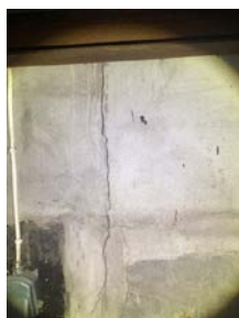
Eksempel på sprekk i grunnmur.
