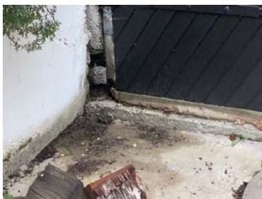
Begynnende råte på kjellerdør.
