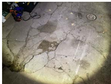
Oppsprekking i gulv i garasje.
