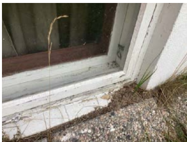
Eksempel på slitasje på vindu.
