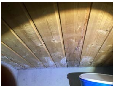
Fuktmerker i himling på ett bodrom.
