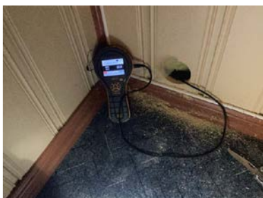
Fuktmåling i utforet veggkonstruksjon på over 20 vektprosent.
