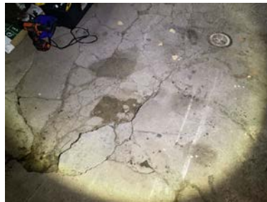
Oppsprekking i gulv i garasje.
