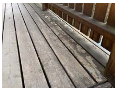
Eksempel på slitasje på gulv.
