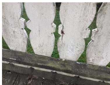
Eksempel på råte i kledningsbord.
