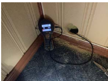
Fuktmåling i utforet veggkonstruksjon på over 20 vektprosent.
