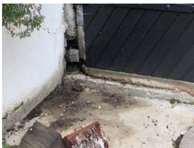
Begynnende råte på kjellerdør.
