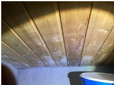
Fuktmerker i himling på ett bodrom.
