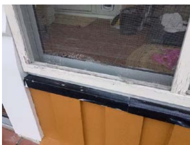
Skade på myggnetting.
