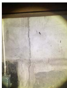
Eksempel på sprekk i grunnmur.
