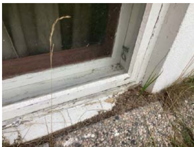
Eksempel på slitasje på vindu.
