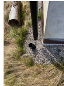
Ikke tilfredsstillende kontrollert bortledning av vann.
