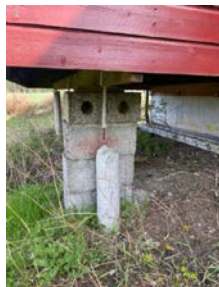
Svikt på fundament. Understøttet av løse lettklinkerblokker.
