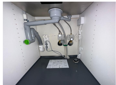
Rørpropplegg i kjøkkenbenk med Waterguard
