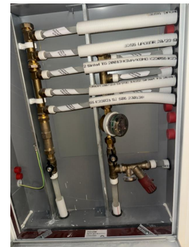
Samleskap med rørkurser og stoppekraner
