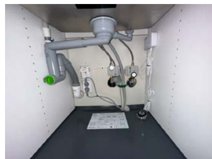
Røropplegg i kjøkkenbenk med Waterguard
