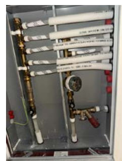
Samleskap med rørkurser og stoppekraner
