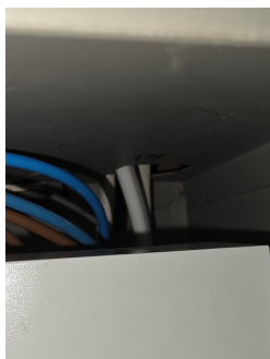
Åpen kabelføring i sikringsskapet
