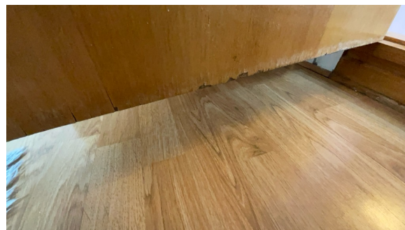
Skade nedkant av baddør.
