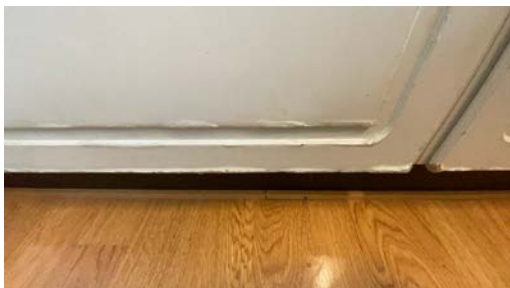
Fuktskade på dører
