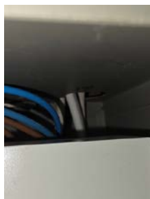
Åpen kabelføring i sikringsskapet
