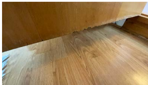
Skade nedkant av baddør.
