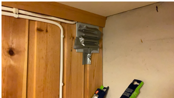
Tettet ventil i vegg.
