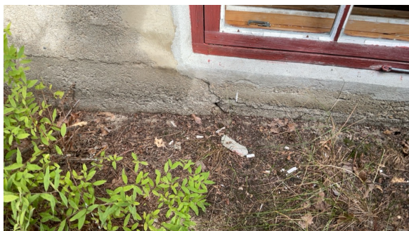
Noe sprekker i mur på grunn av setninger.
