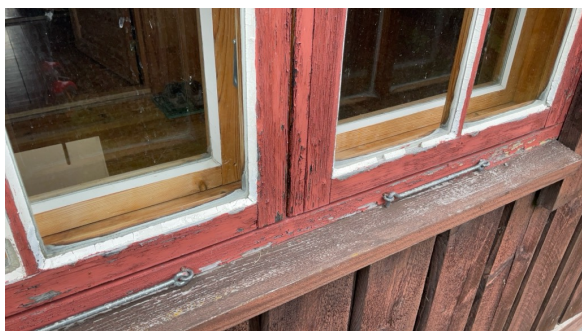
Noe tidsmessig slitasje på vinduer.
