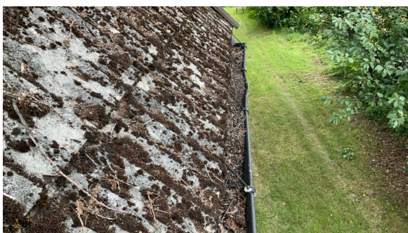
Takrenner med skade.
