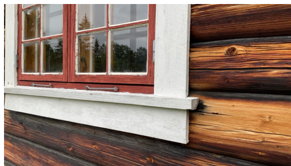
Sidebelistning går enkelte steder ned til vannbrett.
