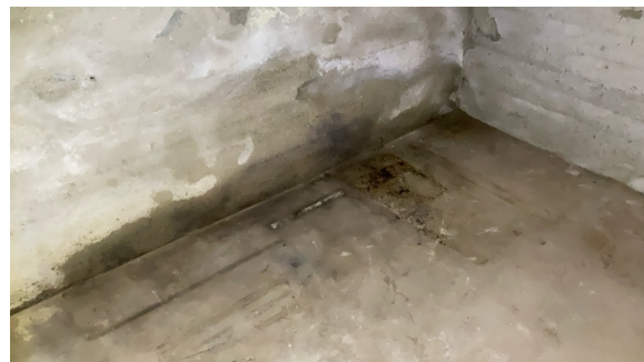
Fukt og saltutslag i kjeller.
