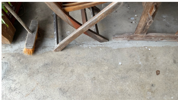
Sprekk i betongdekke.
