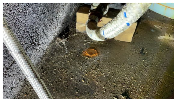
Lekkasje fra vannpumpe.
