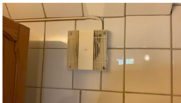
Elektrisk vifte i vegg.
