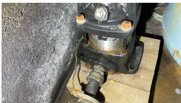
Kondens på vannpumpe.
