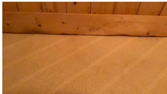
Noe fuktmerker i overgang gulv/vegg.
