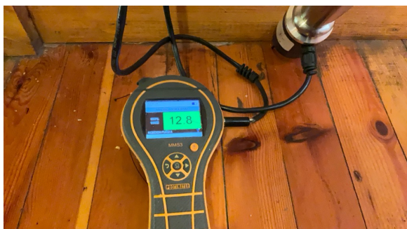
Fuktmåling i treverk i kjeller.
