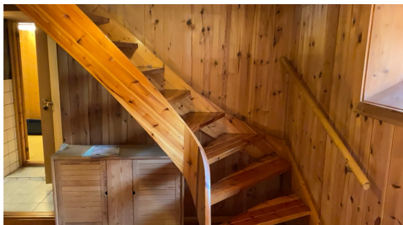
Manglende rekkverk i trapp.
