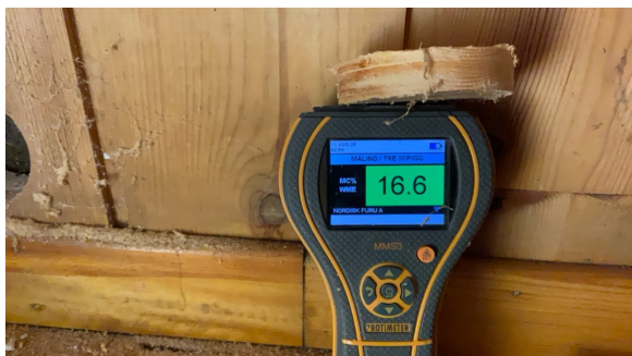
Fuktmåling i panel mot yttervegg.
