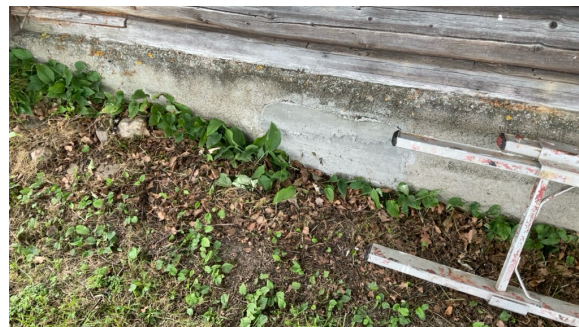
Generell slitasje på grunnmur.
