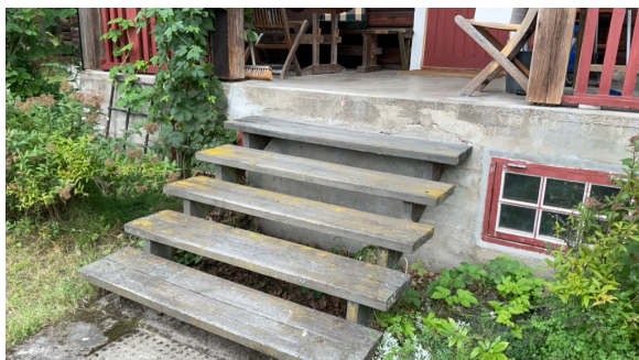
Manglende rekkverk på trapp.
