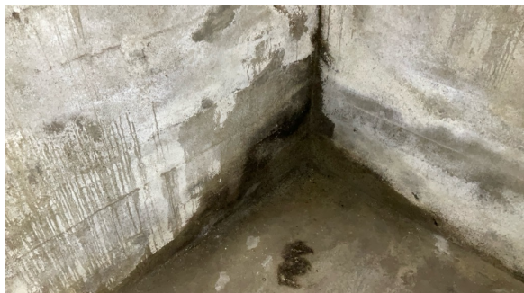
Fukt i kjeller.
