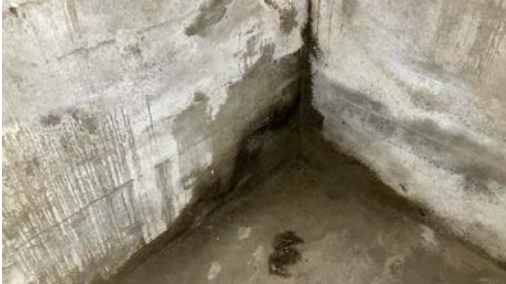
Fukt i kjeller.
