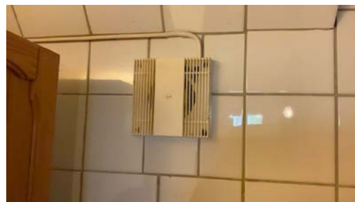
Elektrisk vifte i vegg.
