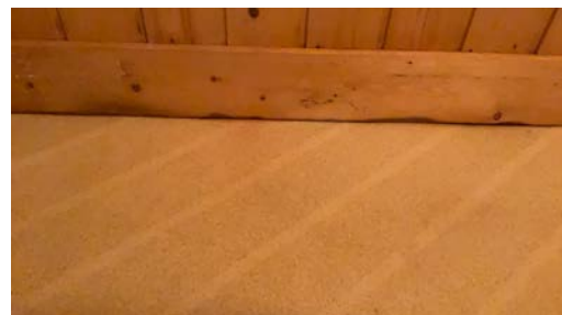
Noe fuktmerker i overgang gulv/vegg.
