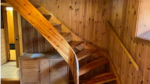
Manglende rekkverk i trapp.
