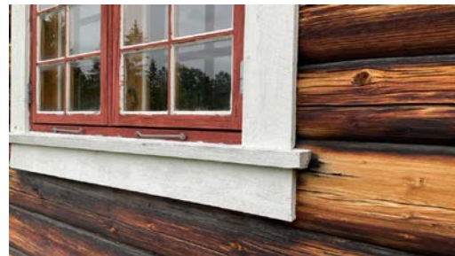
Sidebelistning går enkelte steder ned til vannbrett.
