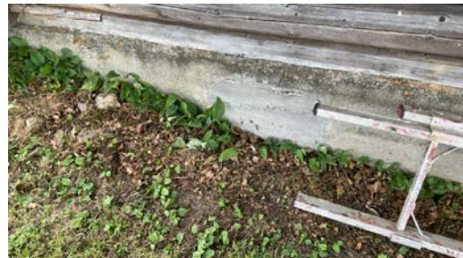
Generell slitasje på grunnmur.
