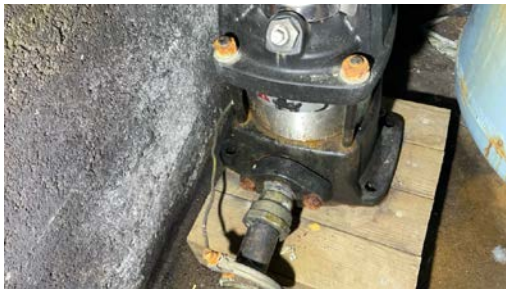
Kondens på vannpumpe.
