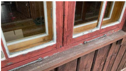
Noe tidsmessig slitasje på vinduer.
