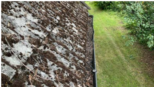
Takrenner med skade.
