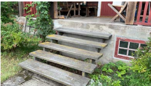
Manglende rekkverk på trapp.
