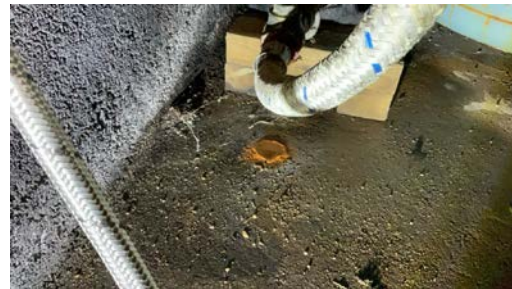
Lekkasje fra vannpumpe.
