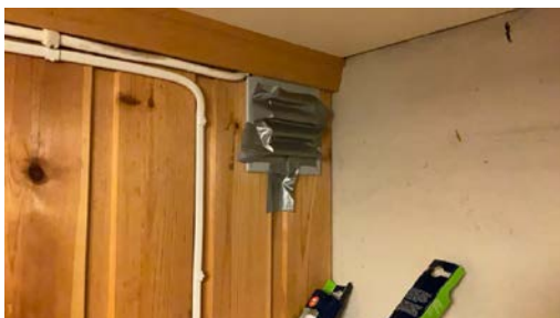
Tettet ventil i vegg.
