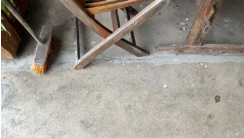
Sprekk i betongdekke.
