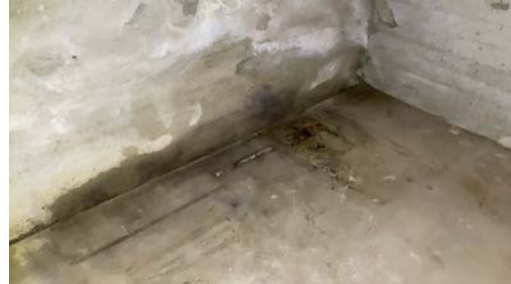
Fukt og saltutslag i kjeller.
