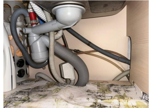
Rørproppleg i kjøkkenbenk
