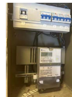
Sikringsskap med automatsikringer.
