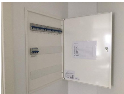
Sikringsskap plassert i stue.
