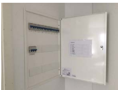
Sikringsskap plassert i stue.
