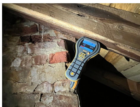
Fuktmåling i treverk viste skadelig fukt.
