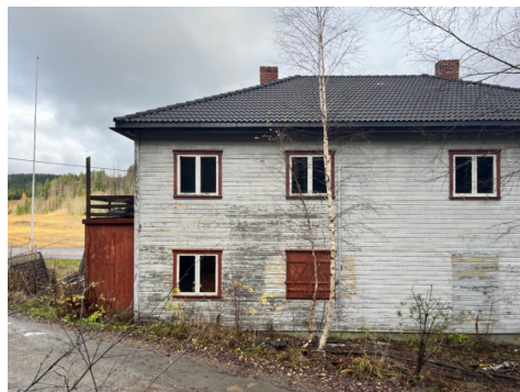
Terreng heller mot bygning.
