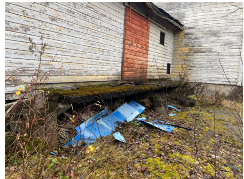
Rampe har store skader.
