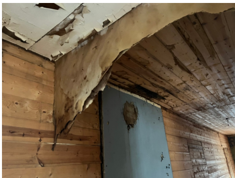
Fuktskader ved piper.
