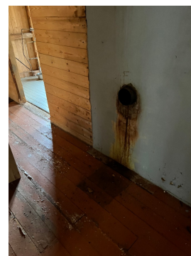
Åpent røykrør må tettes forsvarlig.
