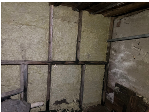
Fuktskader i kjeller.
