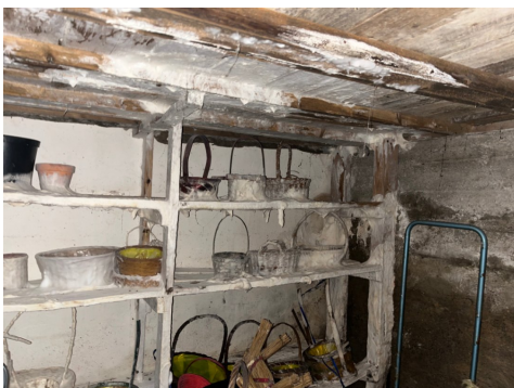
Omfattende soppangrep i kjeller.
