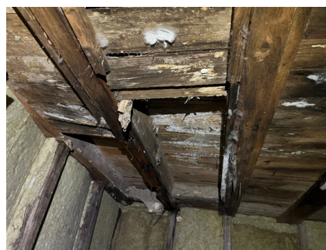
Bjelkelag til kjeller med sopp og råteskader.
