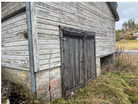
Garasjedør må skiftes.
