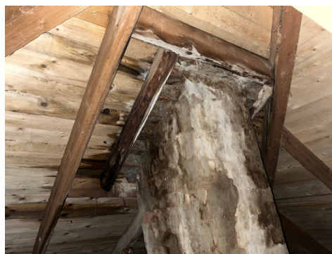
Fuktskader ved gjennomføring av piper.
