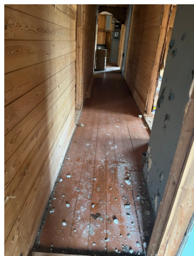
Vann renner ned ved pipe og skader bl.a. bjelkelag.
