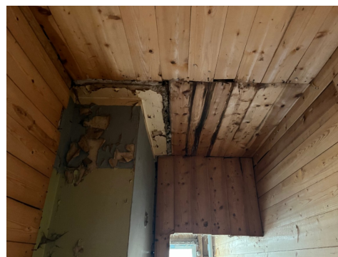
Pipe med avskalet maling og rennemerker etter lekkasje.
