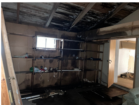
Lager med store fuktskader.
