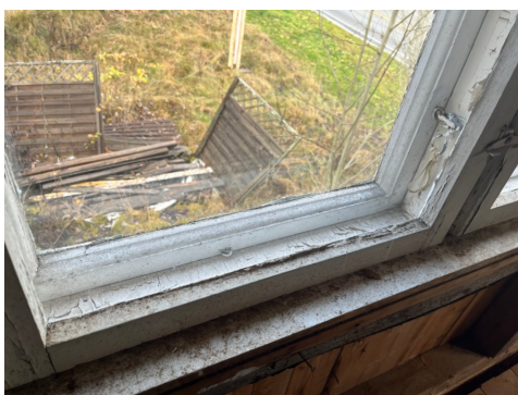
Vinduer med skader.
