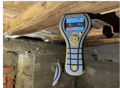
Det ble målt skadelig fukt i trevirke.
