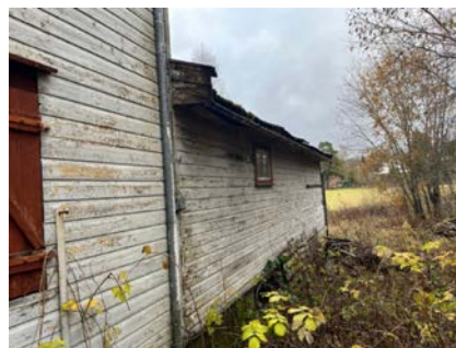
Takrenner og nedløp må skiftes på lagerbygg.
