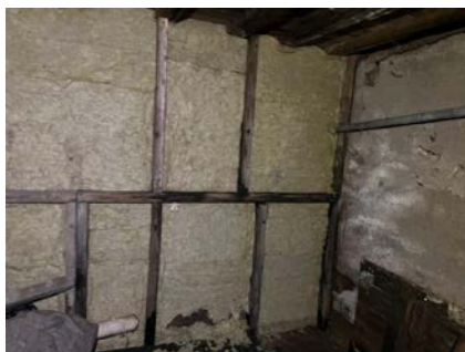
Fuktskader i kjeller.
