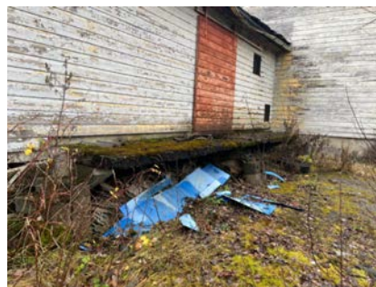
Rampe har store skader.
