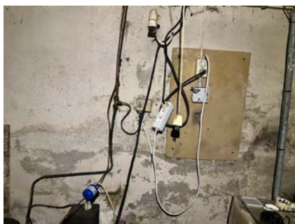
Løse ledninger og åpne koblingsbokser.
