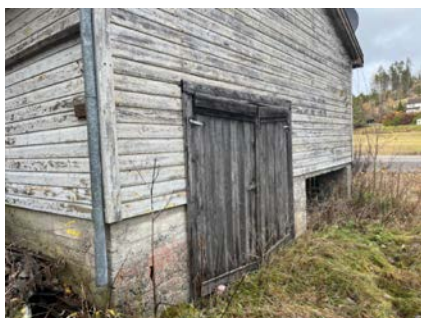
Garasjedør må skiftes.
