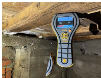
Det ble målt skadelig fukt i trevirke.
