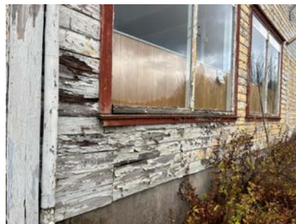
Kledning hoveddel har store skader.
