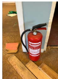
Brannslukningsapparat fra ukjent årstall.
