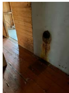
Åpent røykrør må tettes forsvarlig.
