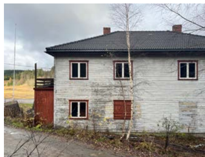
Terreng heller mot bygning.
