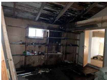
Lager med store fuktskader.
