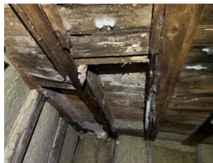
Bjelkelag til kjeller med sopp og råteskader.
