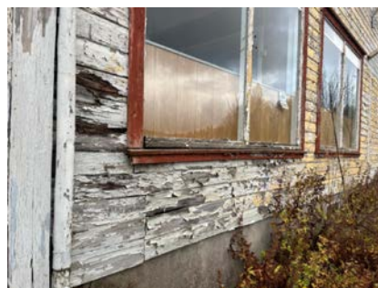
Kledning hoveddel har store skader.
