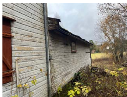
Takrenner og nedløp må skiftes på lagerbygg.
