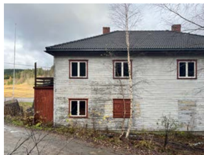
Terreng heller mot bygning.
