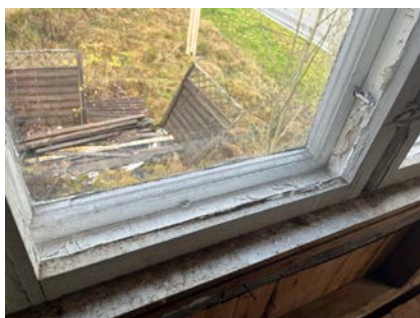
Vinduer med skader.
