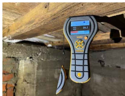
Det ble målt skadelig fukt i trevirke.
