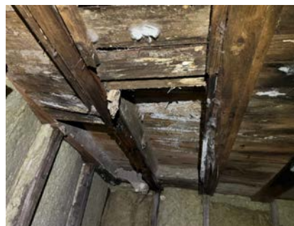
Bjelkelag til kjeller med sopp og råteskader.
