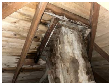
Fuktskader ved gjennomføring av piper.
