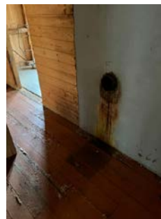
Åpent røykrør må tettes forsvarlig.
