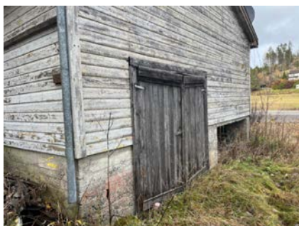
Garasjedør må skiftes.
