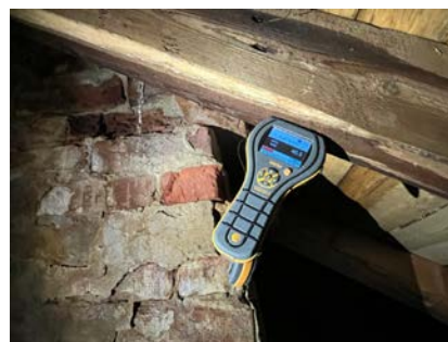
Fuktmåling i treverk viste skadelig fukt.
