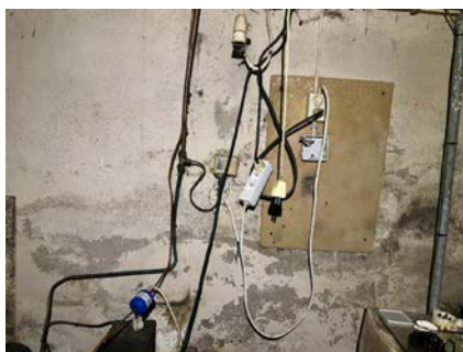
Løse ledninger og åpne koblingsbokser.
