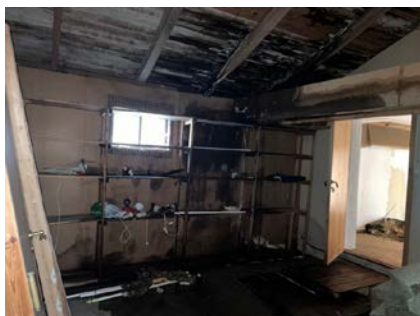
Lager med store fuktskader.
