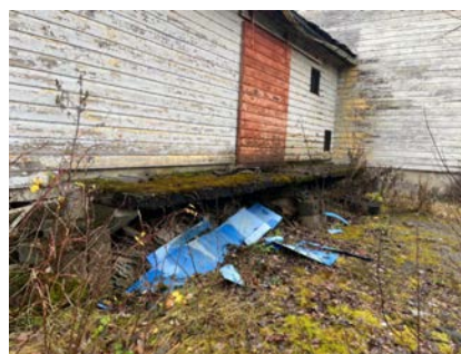
Rampe har store skader.
