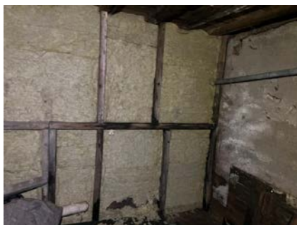
Fuktskader i kjeller.
