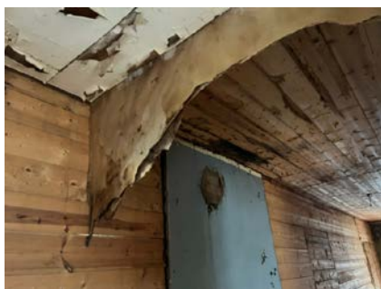
Fuktskader ved piper.
