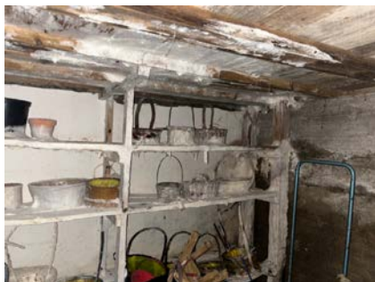
Omfattende soppangrep i kjeller.
