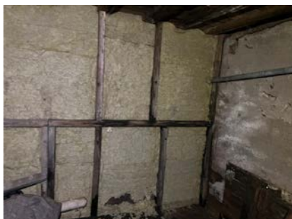
Fuktskader i kjeller.
