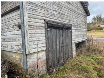
Garasjedør må skiftes.
