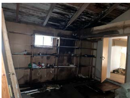
Lager med store fuktskader.
