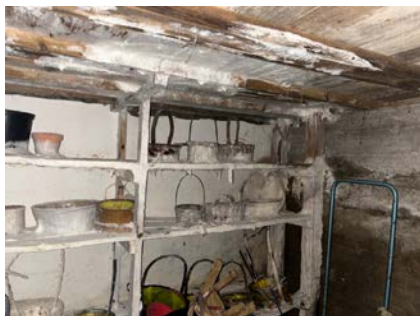
Omfattende soppangrep i kjeller.
