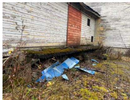
Rampe har store skader.
