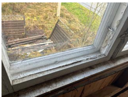
Vinduer med skader.
