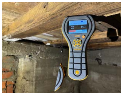
Det ble målt skadelig fukt i trevirke.
