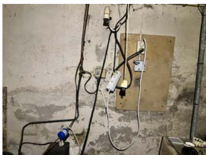
Løse ledninger og åpne koblingsbokser.
