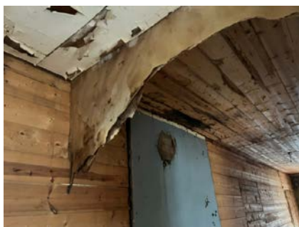
Fuktskader ved piper.
