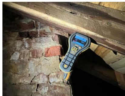
Fuktmåling i treverk viste skadelig fukt.
