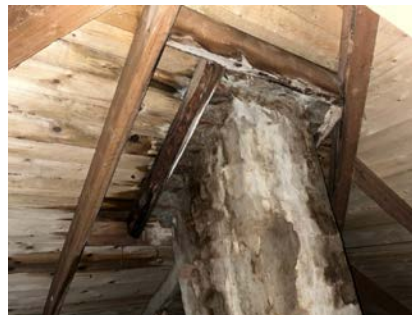
Fuktskader ved gjennomføring av piper.
