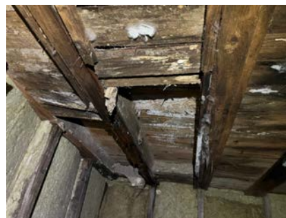
Bjelkelag til kjeller med sopp og råteskader.
