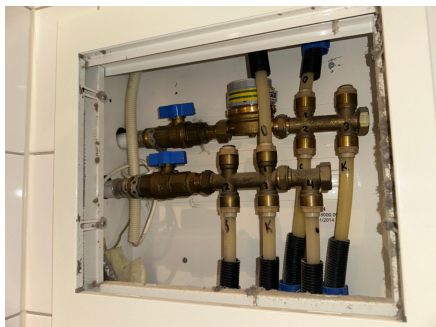
Samleskap med rørkurser og stoppekraner
