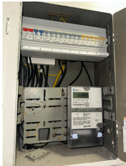
Sikringssskap med automatsikringer.
