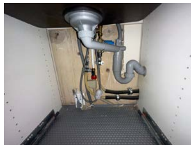
Røropplegg i kjøkkenbenk med Waterguard
