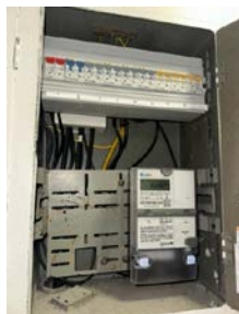
Sikringsskap med automatsikringer.
