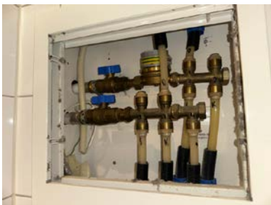
Samleskap med rørkurser og stoppekraner
