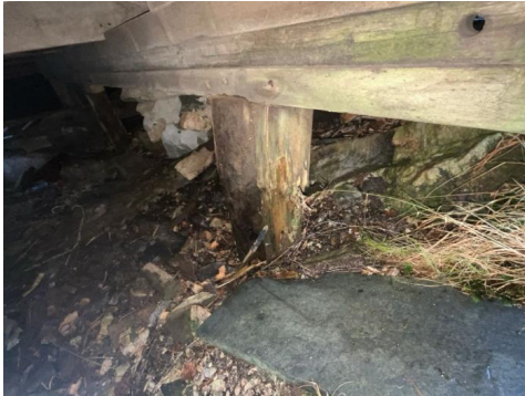
Bilde viser pilar i treutførelse. Det er råteskader i trevirke.
